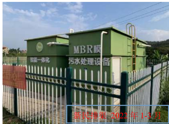
水口村污水处理一体化设备现场
