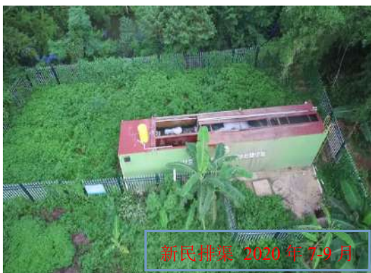
水口村污水处理一体化设备现场
