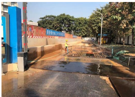
项目出入口洗车池
