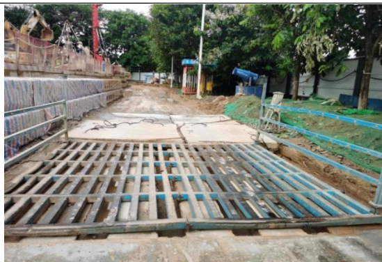
出入口洗车池
